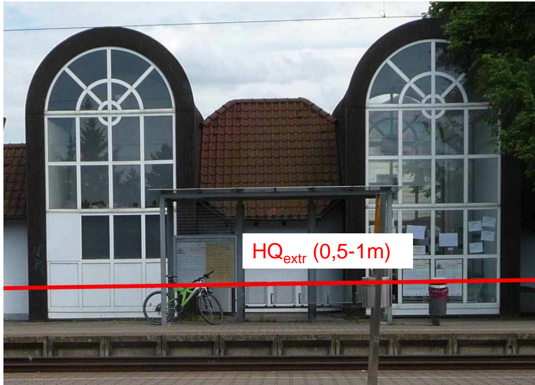
Mögliches Hochwasser am Bahnhof
